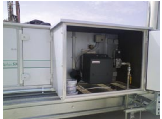
Exemple d'un brûleur Weishaupt dans une centrale de traitement d'air CAIRplus
